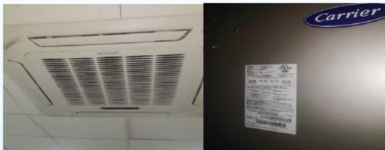
Instalaciones de Aires Acondicionados
